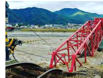
橋脚が落下した上田市別所線
