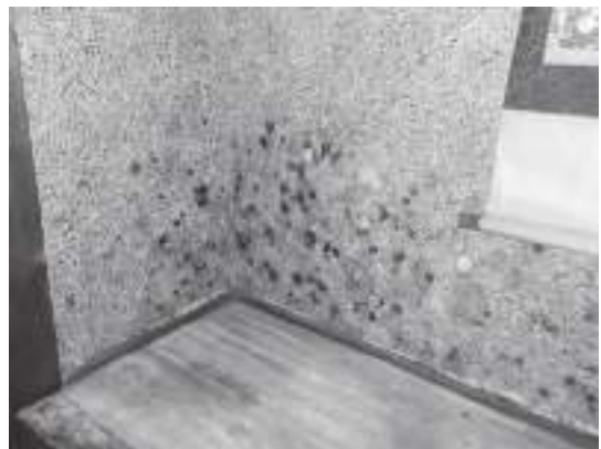
【和室壁】カビ発生の状況
